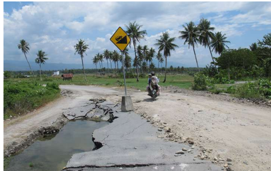
Gambar 12. Jalan yang bergeser setelah gempabumi 28 September 2018
